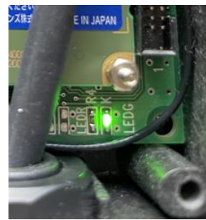
Photo4.3 動作確認ランプ点灯
