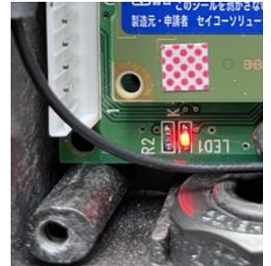
Photo4.1 接続ランプ点灯
